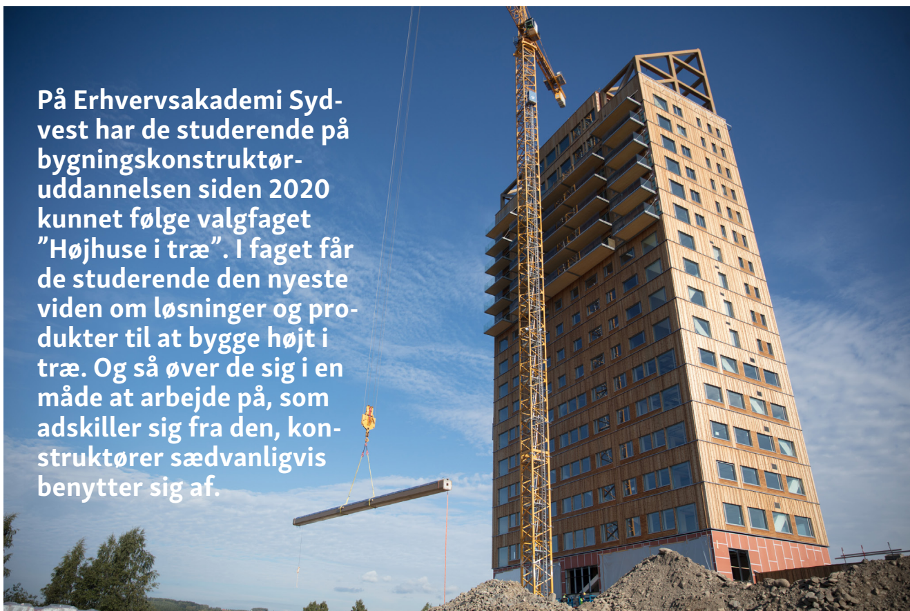
Blandt andet Norge er langt fremme, når det kommer til at bygge højt i træ. Her er det Mjøstårnet i Brumunddal. Foto: Anti Hamar, Moelven Limtre
